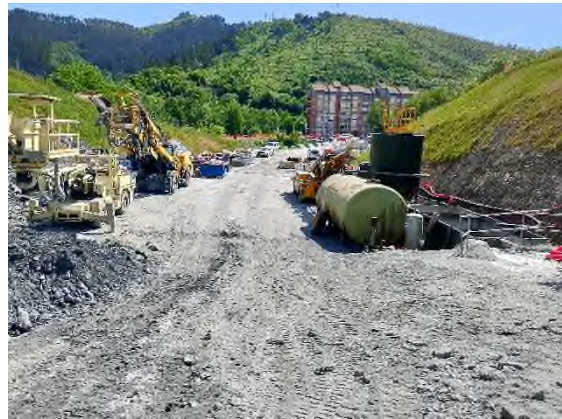
Foto nº32: Instalaciones auxiliares S5
