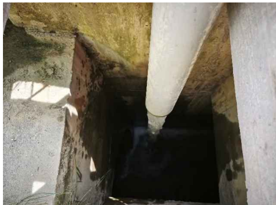
Foto nº12: Vertido depuradora de Markina
