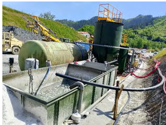
Foto nº27: Planta de tratamiento de Etxebarria.
