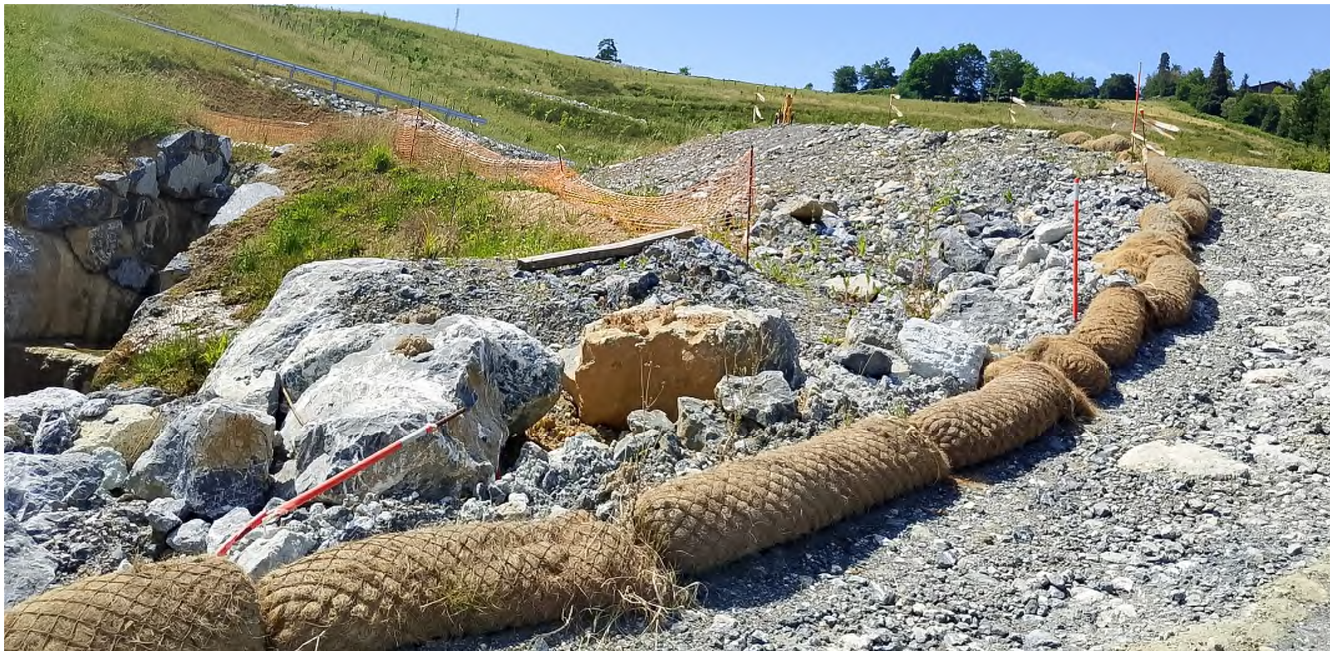
BARRERAS DE RETENCIÓN EN EL CAMINO DE ACCESO AL DEPOSITO DE SOBRANTES
