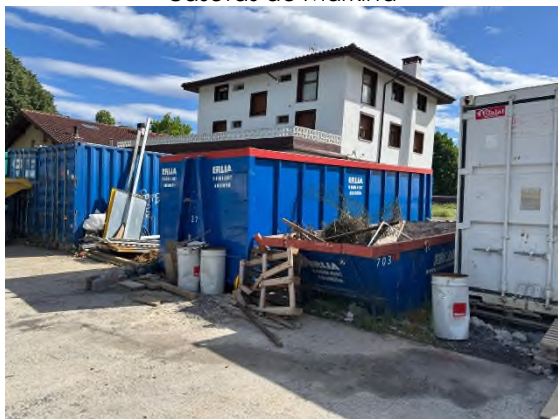
Foto nº39: Contenedores de RNPs habilitados en la zona de casetas de obra Markina.
