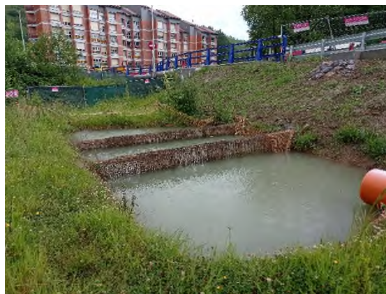
Foto nº17: Balsa de decantación Atain
