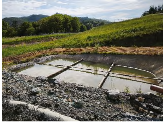
Foto nº25: Balsa de decantación del DS
