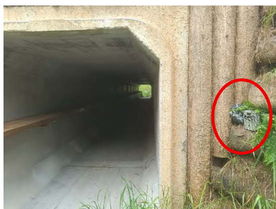
Foto nº56: Camara instalada en la MC2
