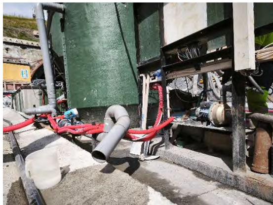
Foto nº13: Vertido depuradora de Etxebarria
