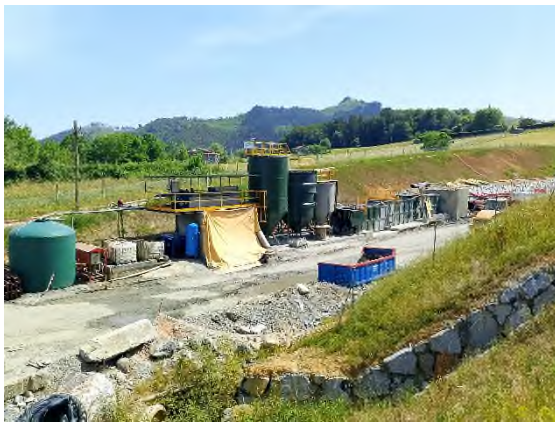
Foto nº26: Planta de tratamiento de Markina
